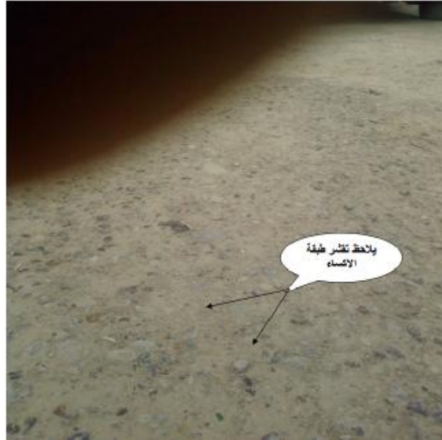
صورة رقم (2) توضح العيوب والاختلافات في طبقة الاكساء (تقشر السطح الخارجي لطبقة الرصف الاسفلتية) * (Site photograph)
