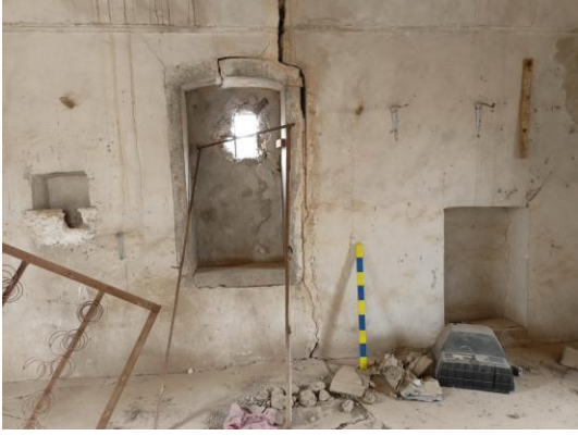
الصورة (٥٦) نافذة وحنية في الضلع الغربي للغرفة (١) في دار بخوسيبي، تصوير الباحثة
